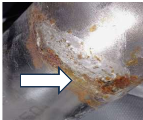
Wyciek korozyjny w miejscu spawu
